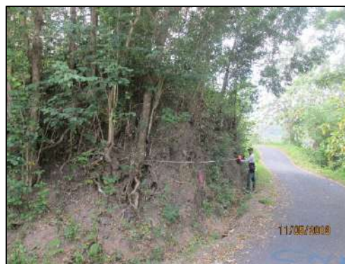
Gambar 8. Kenampakan lereng andesit dengan struktur kekar berlembar pada pinggir jalan LP S05
