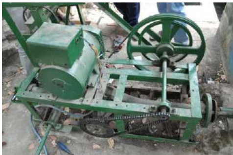
Gambar 10. Pengujian Generator AC1 fasa dari Mikrohidro pada aliran ilrigasi.
