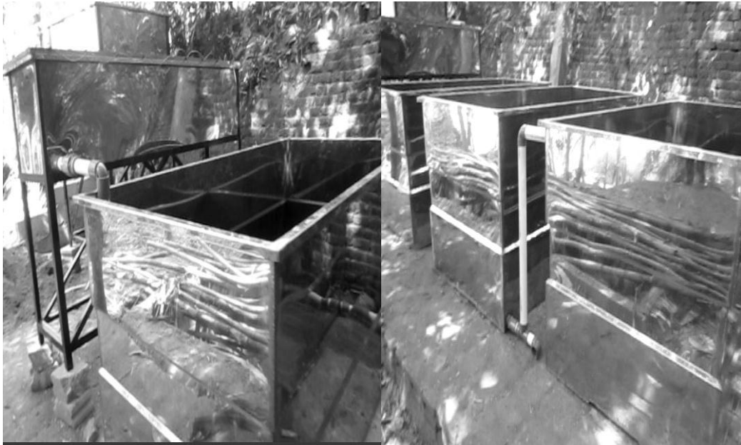
Gambar 6. Instalasi pengolahan limbah cair batik yang sudah terpasang di lokasi mitra pengrajin batik di Kelurahan Gulurejo, Kecamatan Lendah Kulon Progo
