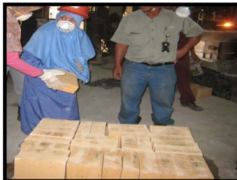
Gambar 6. Foto Batu tahan api jenis magnesia (MgO brick ) yang digunakan lining pada Tanur listrik
