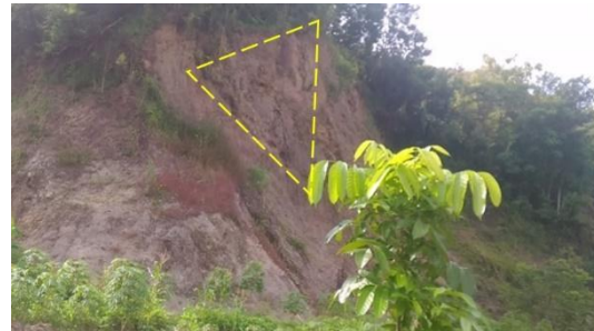
Gambar 5. Longsoran baji di lereng RS1
