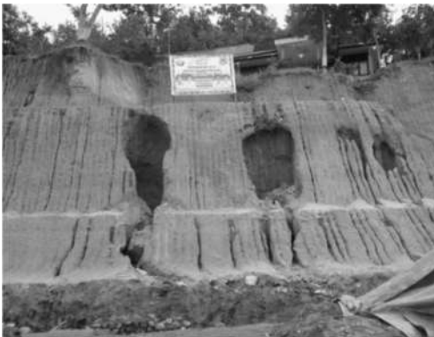
Gambar 5. Tampak depan lereng tergali beserta kondisi keruntuhan pada badan lereng (Dokumentasi, 2016)
