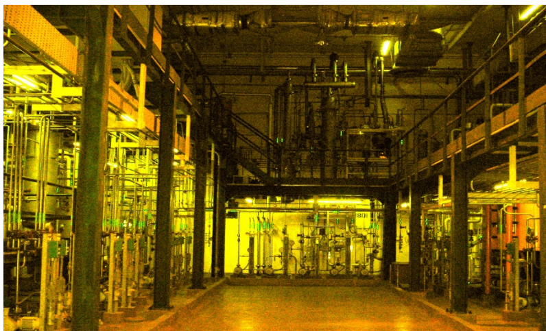
Gambar 1 instalasi Pemurnian dan Konversi PCP
