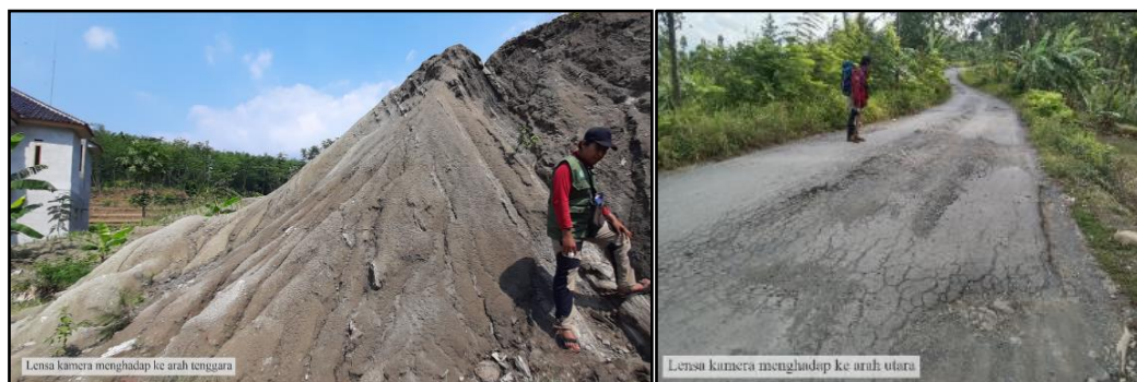
Gambar 7. Longsor batulempung pada litologi perselingan kalkarenit dengan batulempung (kiri) dan Kondisi jalan rusak – bergelombang di atas litologi perselingan kalkarenit dengan batulempung (kanan)
