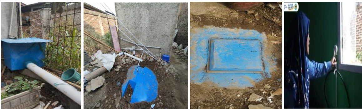
Gambar 8. IPAL: Bak inlet/kontrol, biodigester, bak outlet, saluran gas, dan manometer
