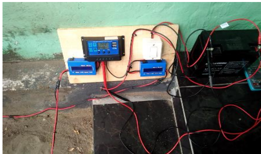
Gambar 5. Papan Kontroler, Saklar dan Baterai
