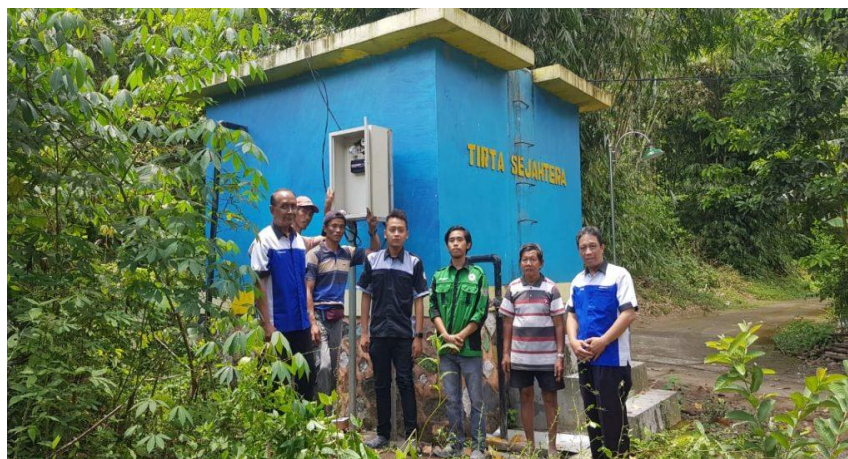
Gambar 8. Hasil instalasi pembangkit listrik tenaga mikrohidro (PLTMH)
