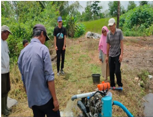
Gambar 11. Pengoperasian Pompa Air
