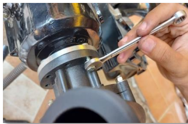
Gambar 7 Pompa Air Terpasang
