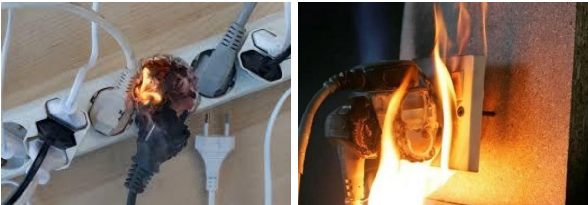
Gambar 3. Akibat tidak mentaati PUIL 2000 terjadi kebakaran pada instalasi listrik
