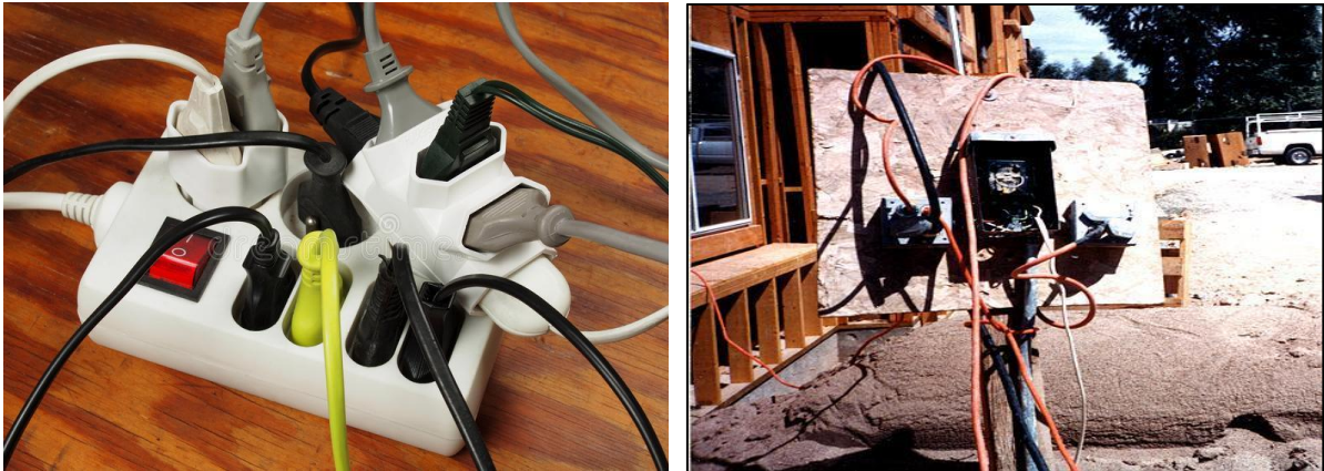
Gambar 4. Model instalasi yang tidak memenuhi syarat instalasi listrik PUIL 2000
