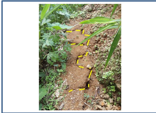
Gambar 4. Rekahan pada zona lapukan meningkatkan porositas yang memperbesar infiltrasi air hujan.
